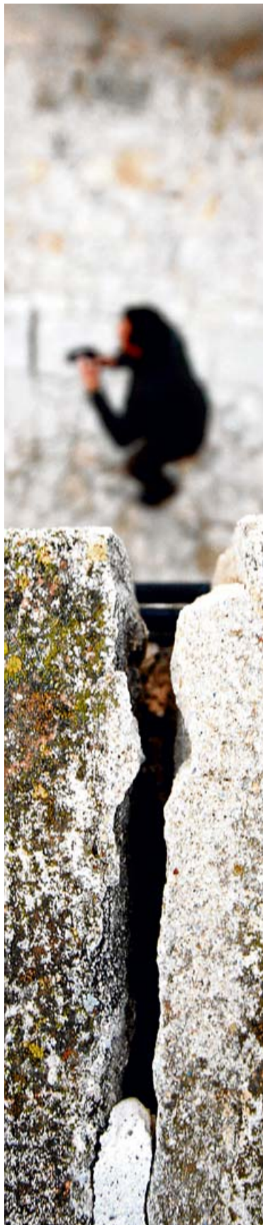
■ Achtung, so eine Mauer hält nicht ewig ... FOTO: ARJONES
